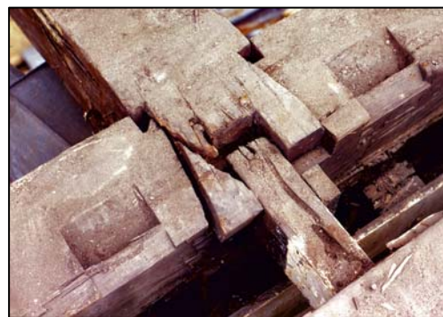
Falla de un ensamble en "cola de milano" por la disminución de la sección resistente, debido a la superposición de cortes (casa Botica del Comercio Foto JUV 1995).
