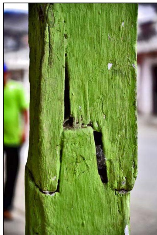
Espera en Boca de Lobo en una columna de fachada, mostrando deterioro, Puerto López, Manabí (Foto JUV 2009)
